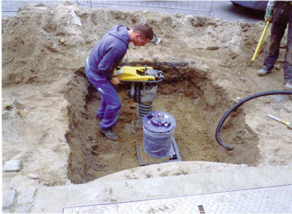
Der Einbau eines 3S 1000 D Stellantriebs. Zu erkennen ist die große verdrehsichere Trageplatte des Systems Berliner Kappe, die im gut verdichteten Erdreich bis über 2000 Nm verdrehsicher ist.
